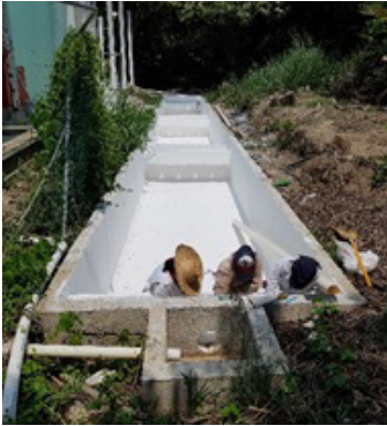
Figura 60. En cada cambio de soporte debe asegurarse que el humedal no presente filtraciones. Fuente: elaboración propia.
