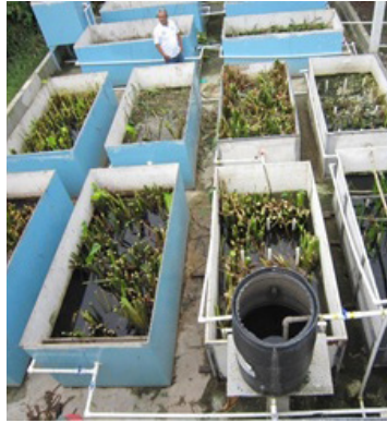
Figura 57. Poda y extracción de plantas para recuperar volumen y porosidad del humedal.
