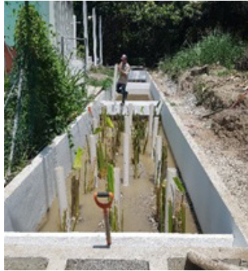
Figura 61. Se deben instalar pozos de monitoreo y venteo con la distribución adecuada de las plantas. Fuente: elaboración propia.
