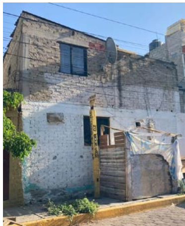
Figura 4 (derecha).- Poste amarillo tipo IV que señala el paso de un ducto, colindante con construcción habitacional. Foto: Valentín Pérez Cruz.
